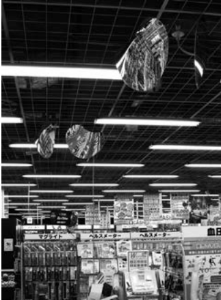
ヨドバシカメラに設置されたミラー「ふわり」 (現在は製造していない商品) ヨドバシカメラでは、ミラーを防犯用としては使っていなかった
